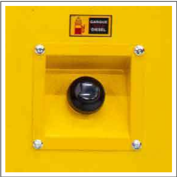
Carga de combustible
