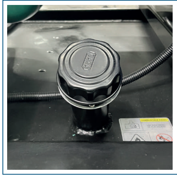
Tanque de combustible
