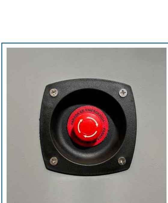
Parada de emergencia externa
