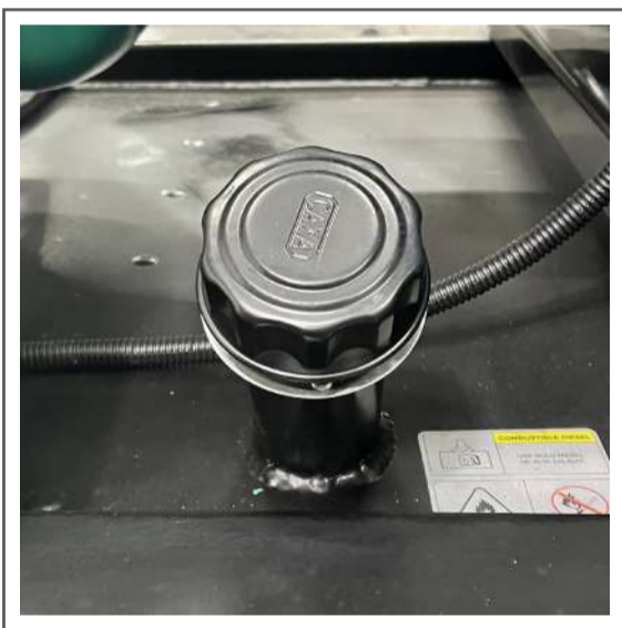
Tanque de combustible
