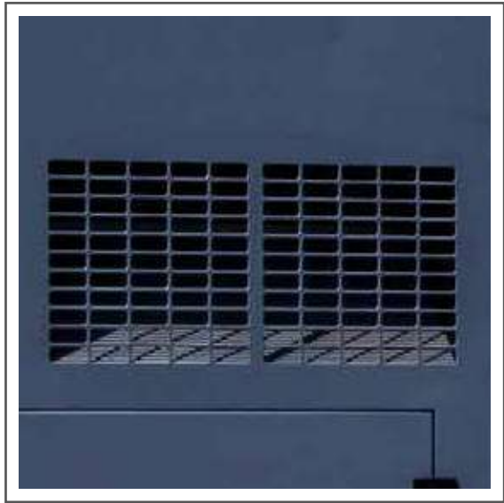
Ductos de ventilación
